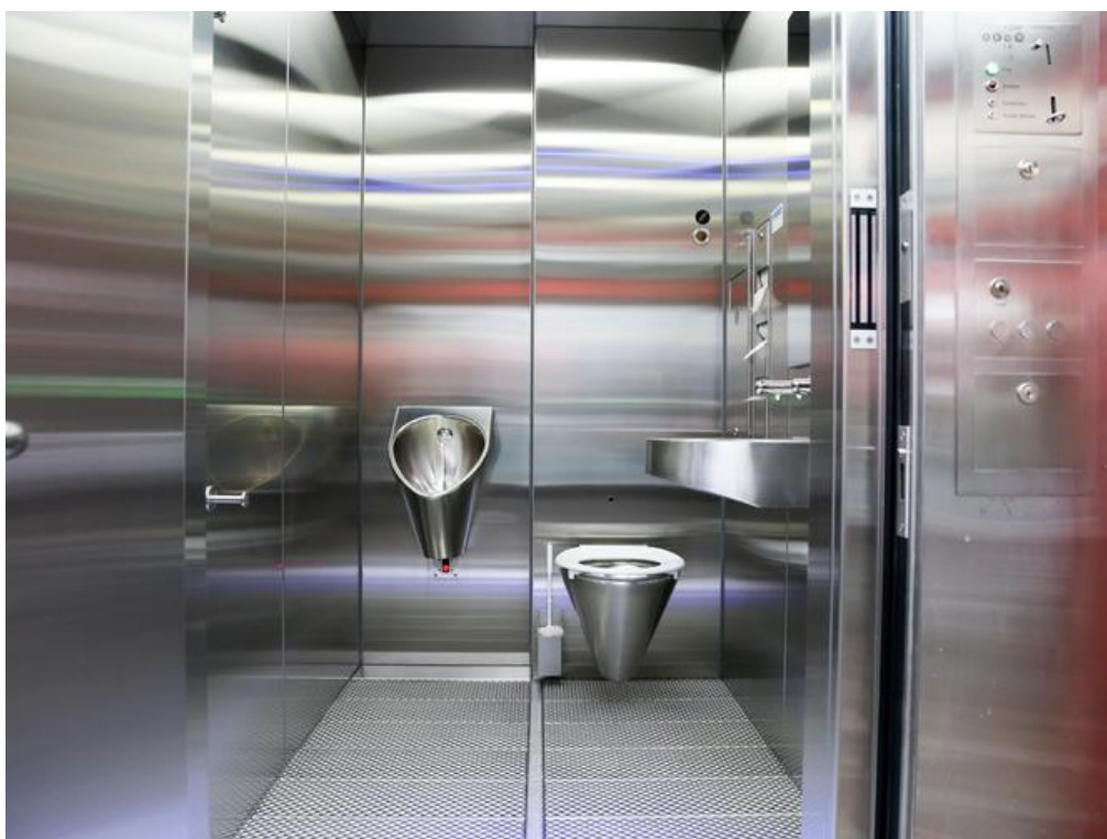
Chromstahl: Die neuen WCs sind laut SBB vandalensicher und einfach in der Reinigung. (Bild: Nathalie Guinand)
