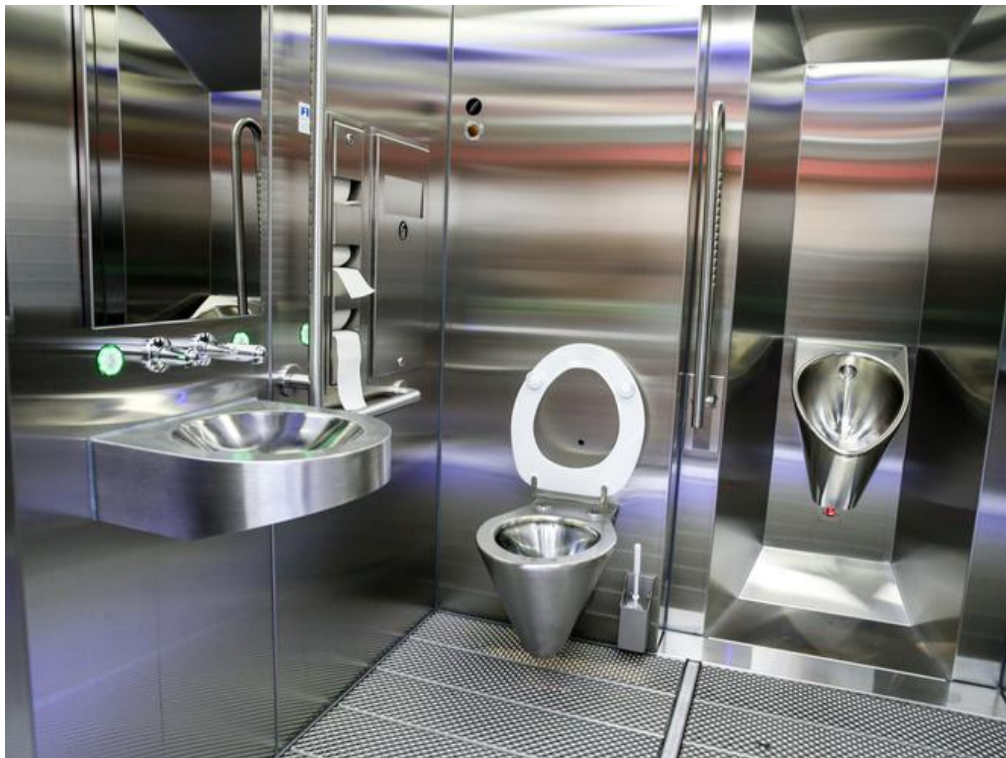
Das Behinderten-WC mit Wickeltisch, zudem ist ein Urinal vorhanden. (Bild: Nathalie Guinand)
